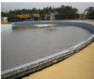
プールサイドが壊れた海浜公園
