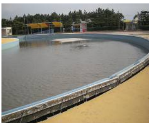
プールサイドが壊れた海浜公園
